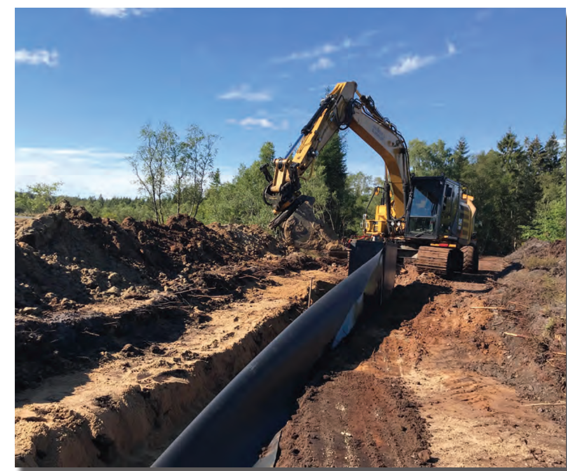
En membran på 141 meters længde er nu med til at holde på vandet i mosen
