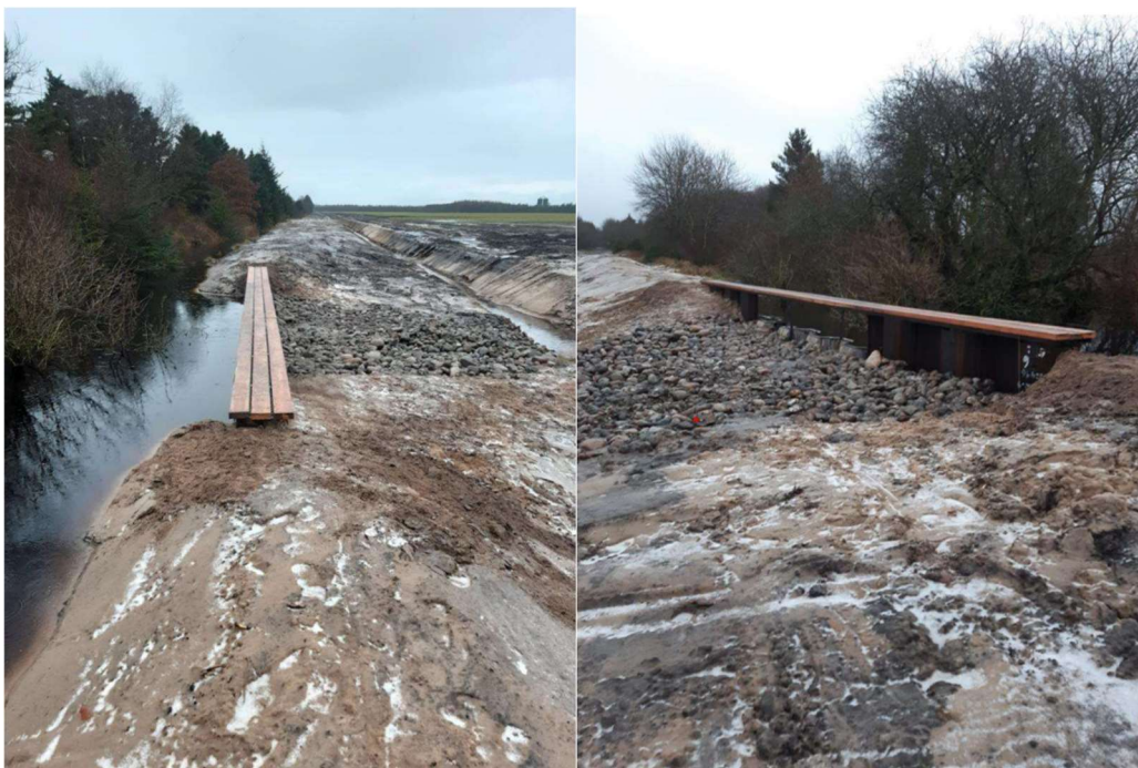
Hovedstem (anlæg 3) og del af membrandæmning (anlæg 1 og 2)
